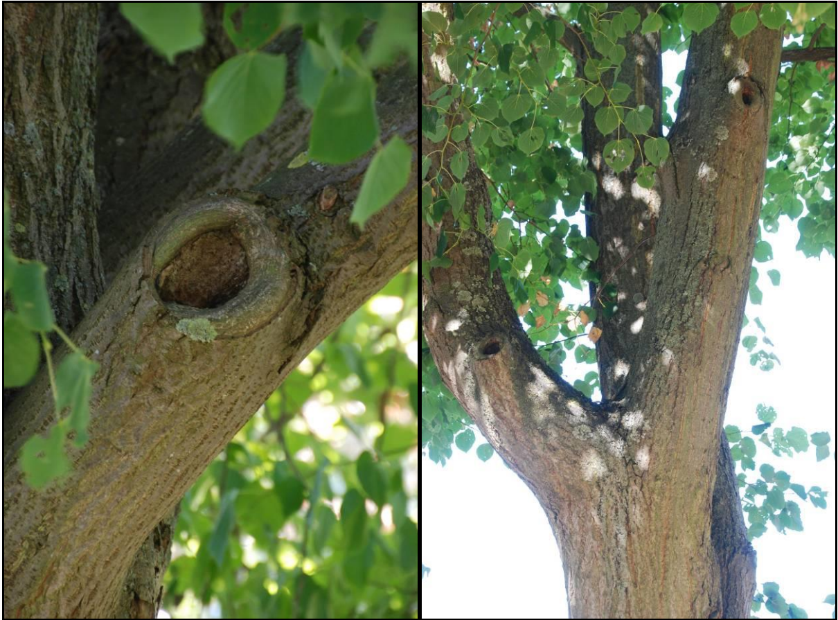
Abbildung 8: In den Linden im westlichen Vorhabenbereich konnten jeweils Baumhöhlen als Sonderstrukturen festgestellt werden, die für Höhlenbrüter oder Fledermausarten einen Teillebensraum darstellen könnten.
